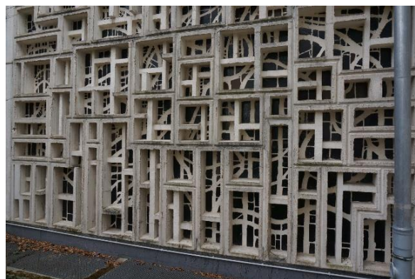
Betonglasfenster der St Mauritiuskirche in Wiesbaden mit Abplatzungen an den Betonstegen
