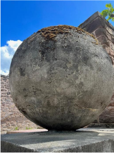
Mathildenhöhe, Darmstadt, Die „Zierkugel 1“ wurde 2014 restauriert, zeigt aber bereits neue Schadensbilder
