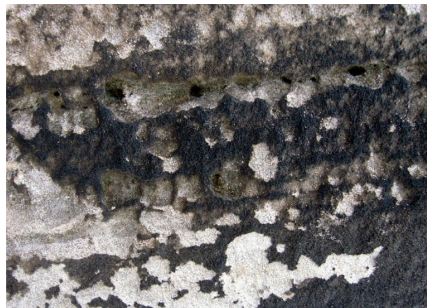
Trier, Porta Nigra: Abplatzung der schwarzen Kruste auf den hellen Sandsteinen
