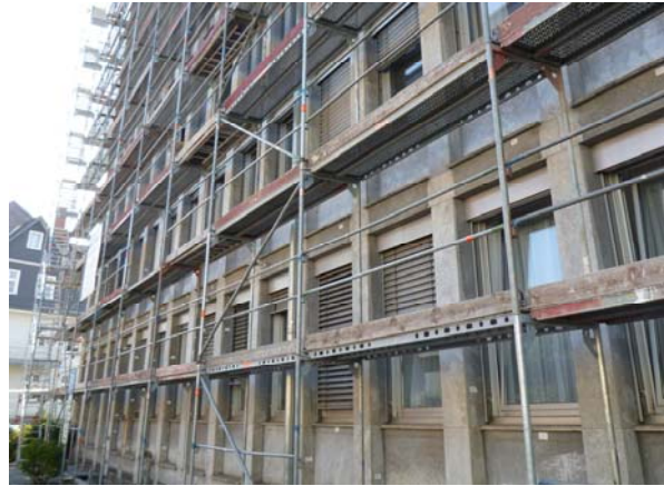
Wetzlar, ehem Verwaltungsgebäude, Fa. Buderus, Krensheimer Muschelkalk, Goldbank. Das größte Manko der Fassade liegt in den zu klein und zu gering dimensionierten Aufhängungen. Die Steinplatten sind meist nur an 2 Punkten verankert und nicht wie gefordert durch eine 4-Punktaufhängung. Des Weiteren sind die Aufhängungen stark korrodiert.
