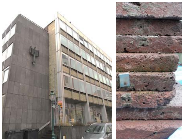
Fulda, ehemaliges Telekomgebäude. Die markant roten Michelnauer Schlackentuff Platten gestalteten die rechte Fassade, links ist schwarzer Basalt verwendet worden. Die abgenommenen Tuffplatten dürfen aufgrund ihrer geringen Biegezugfestigkeit alle nicht mehr reappliziert werden.
