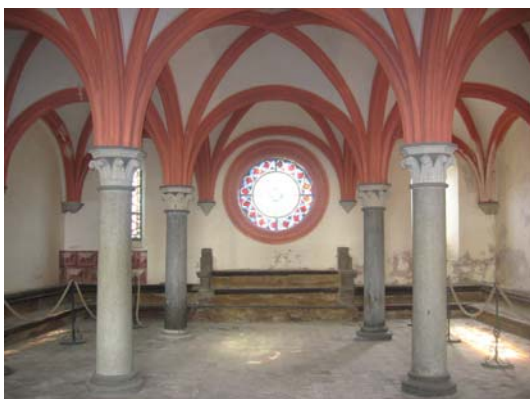
Abtei Rommersdorf, Kapitelsaal, starke Feuchteschäden
