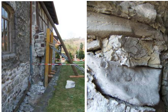
Teileinsturz gipshaltigen Mauerwerks und Zersetzung des Injektionsmörtels infolge Treibmineralbildung durch Reaktion des Gipses mit einem modernen Verpressmörtel.
